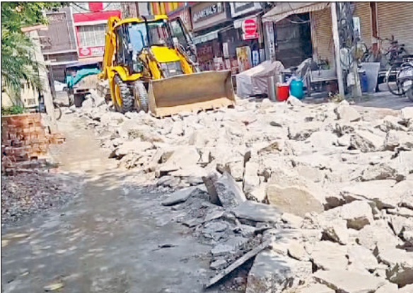
रोहतक। डीएलएफ कॉलोनी में सड़क की हालत।
